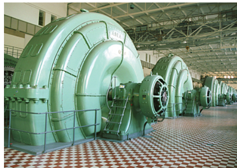
Vannkraftturbin Foto: Vattenfall
